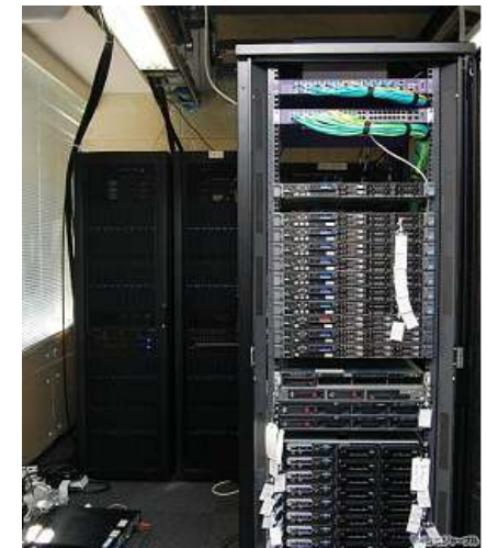
169台のコンピューターを並列化した 東京大学のクラスターマシン
